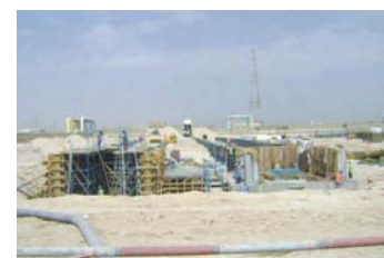
カタール Ras Abu Fontas A1 発電・淡水化プロジェクト
